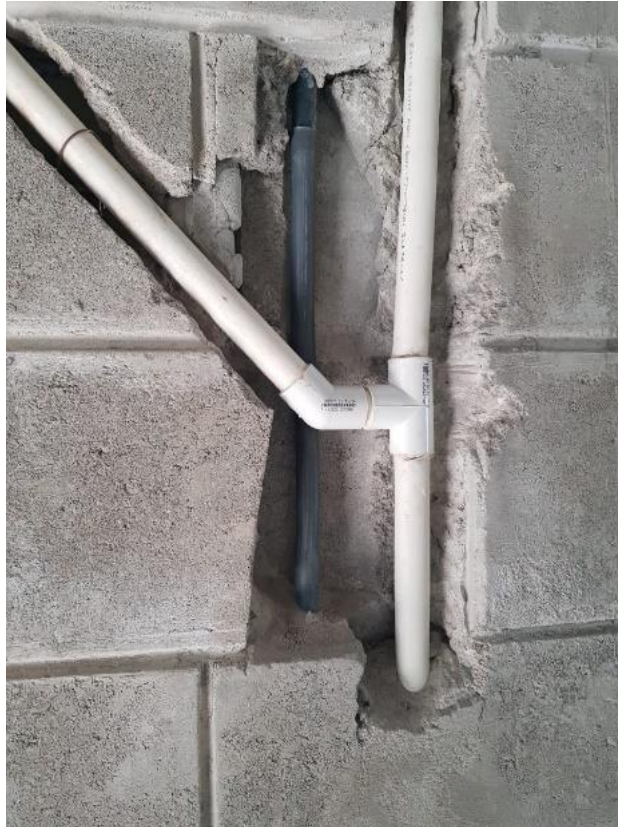
Ilustración 12. Conflicto entre instalaciones eléctricas e hidrosanitarias.
