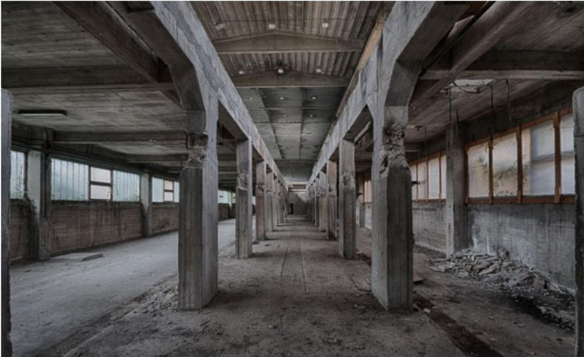
Ilustración 10. -Falla de columna
