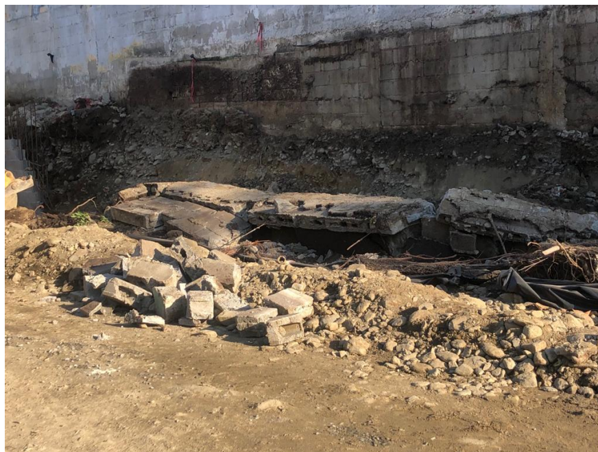
Ilustración 78 – Imprevisto (Desprendimiento de tierra sobre área de trabajo)
