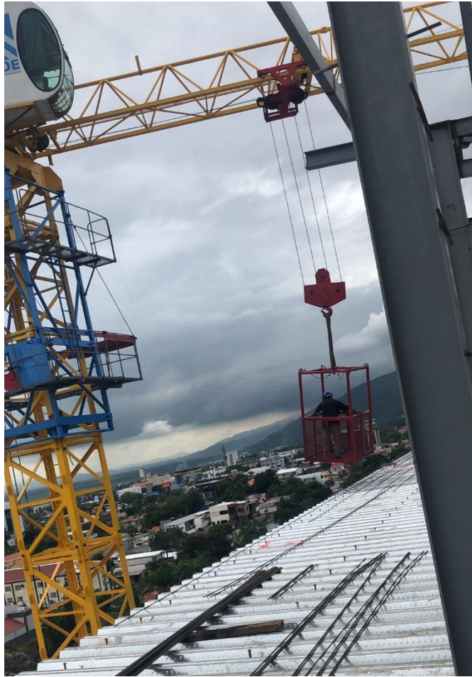
Figura 4. Movimiento de personas con la grúa a falta de gradas.
