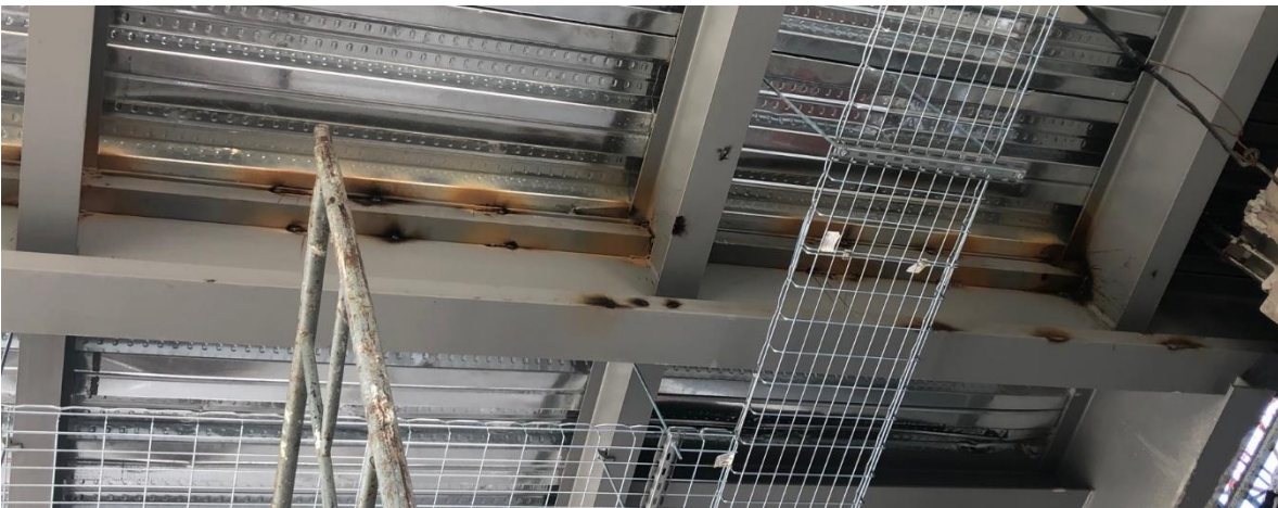
Figura 8. Refuerzo sin resoldar.
