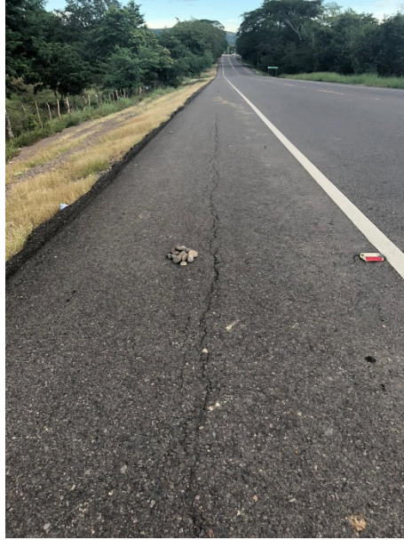
Anexo 13 – Grieta longitudinal en el hombro izquierdo
