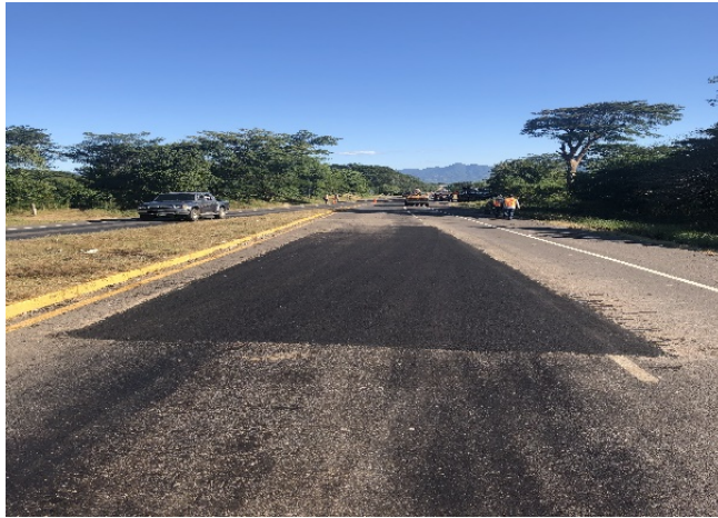
Anexo 27 – Ahuellamiento EST. 87+202.2 DER
