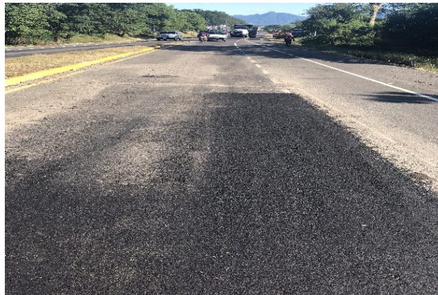
Anexo 28 – Ahuellamiento EST. 87+221.0 DER
