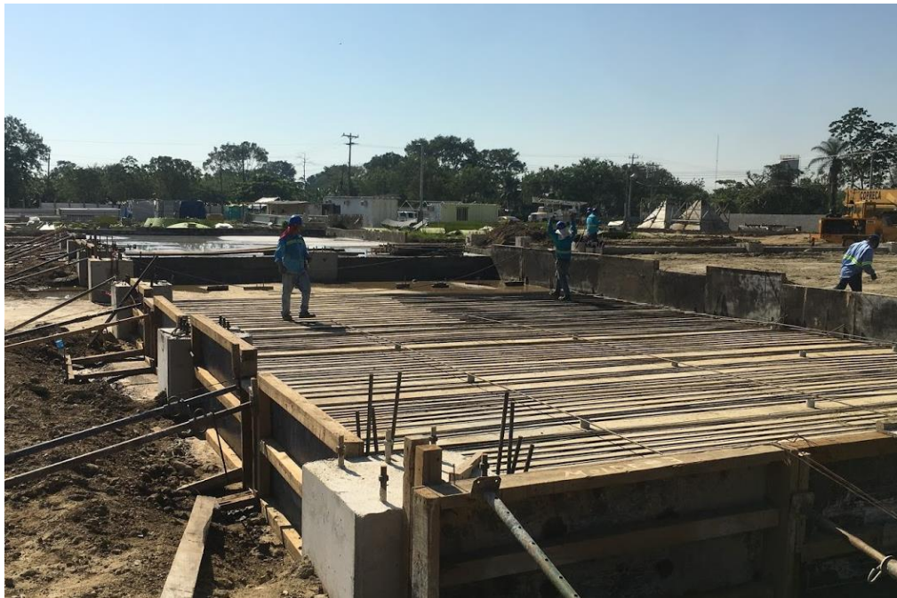
Ilustración 25. Losa de Ensayado y Paletizado
