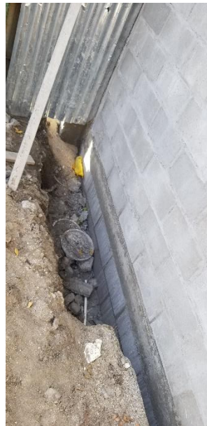
Figura 15. Sobre elevación de bloques en cerco perimetral
