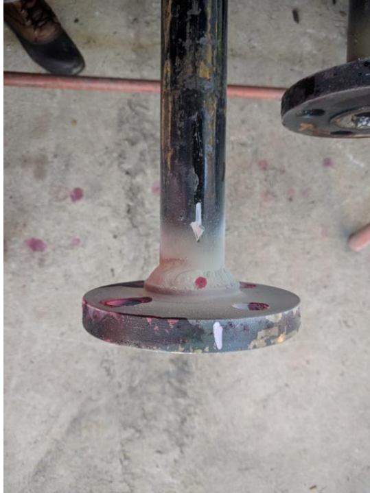
Figura 8. Fuga de Soldadura Causada por Poro
