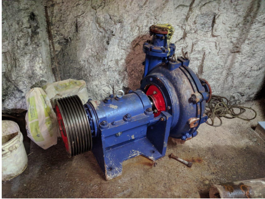
Figura 3. Estado de Bomba de Succión Nivel 24-50
