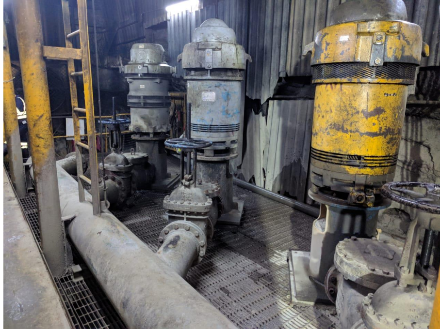
Figura 10. Estación de Bombeo Nivel 23-50
