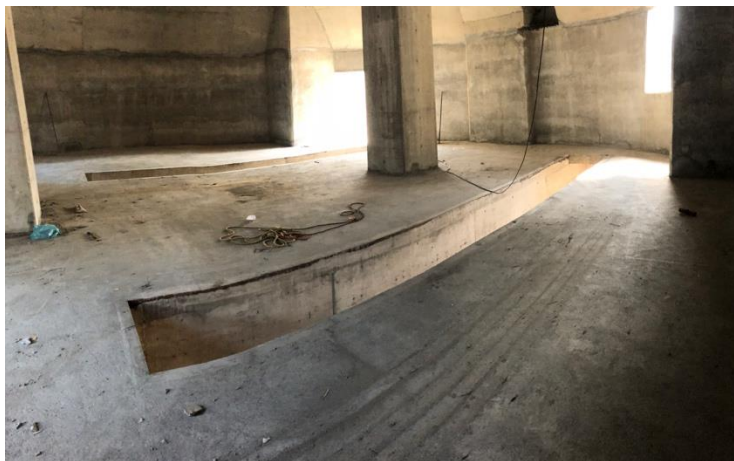
Figura 6. Resane de losa de concreto reforzado nivel 6.80 msnm. y paredes de silo.
