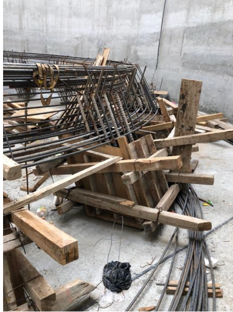
Figura 7. Encofrado de columnas de base de cono de concreto reforzado del silo no. 14.
