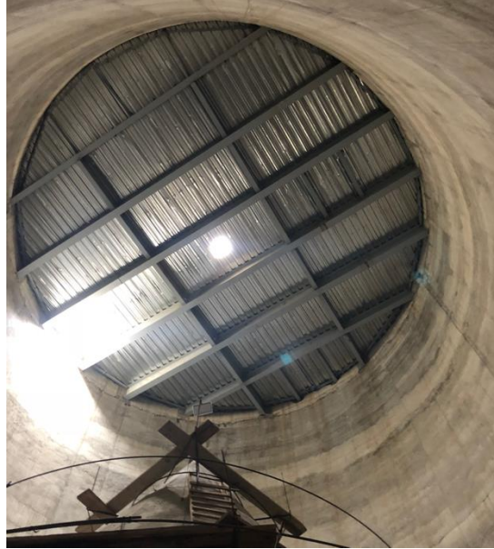
Figura 25. Agujeros en losacero de cerramiento, 36 msnm.
