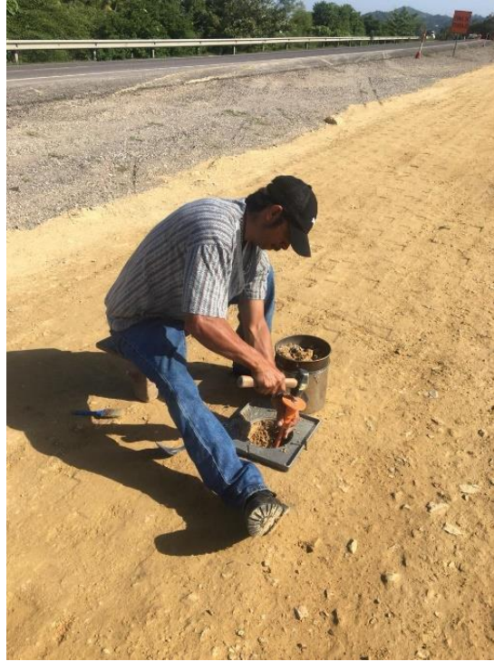
Ilustración 3. Realización de ensayo in situ del cono de arena para determinación de compactación de campo
