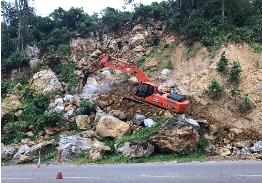
Ilustración 5. Remoción de escombros debido a derrumbe a la altura de Pito Solo
