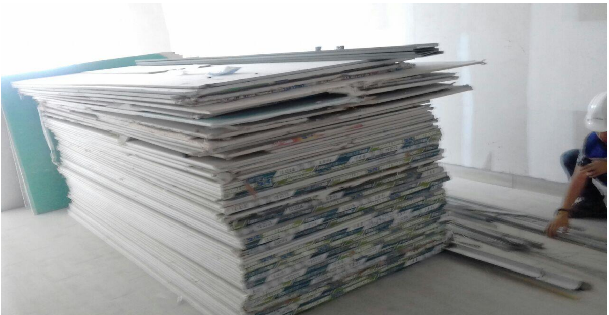
Ilustración 2 Tabla Yeso disponibles en edificio de Hotel
