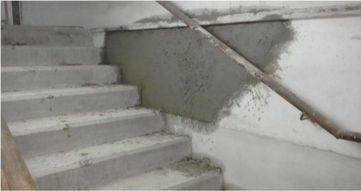
Ilustración 3 Repello en viga de cubo de gradas
