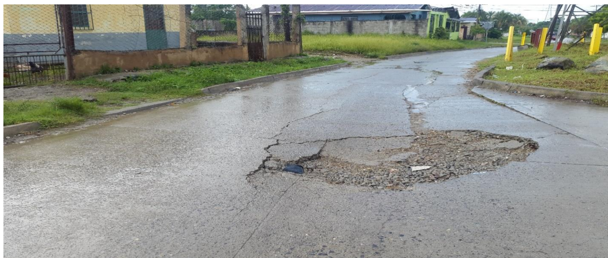
Ilustración 1. Hundimiento en pavimento
