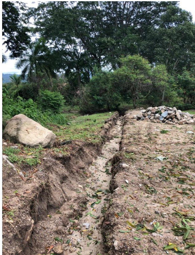
Figura 60. Canal provisional hacia quebrada existente
