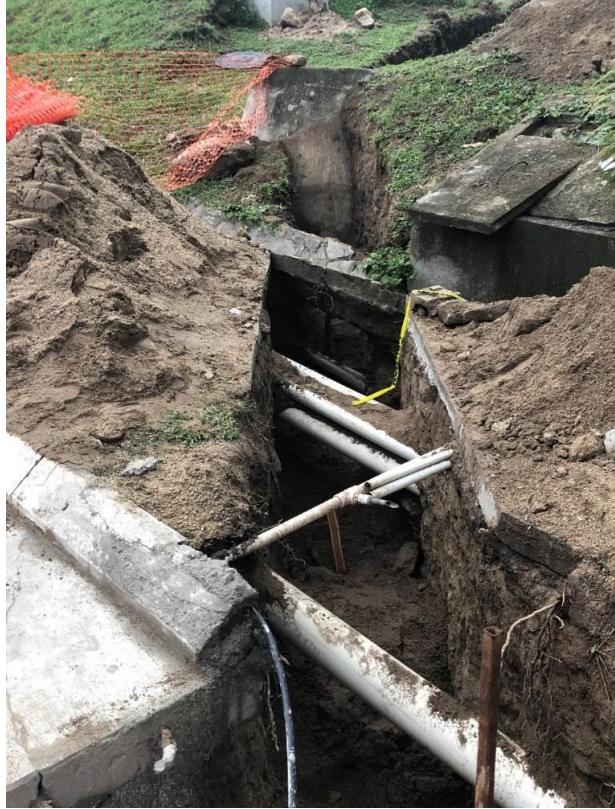
Figura 51. Tuberías eléctricas y AP encontradas en tramo a excavar
