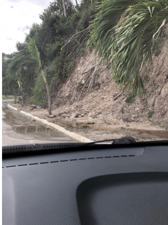
Figura 65. Derrumbe sobre canal
