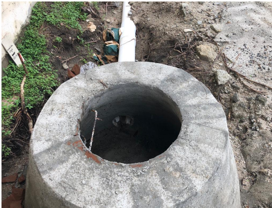
Figura 84. Pozo cabecero colector área verde exterior
