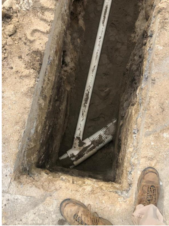
Figura 77. Conexión de tubería pvc 4" con colector principal por medio de una abrazadera
