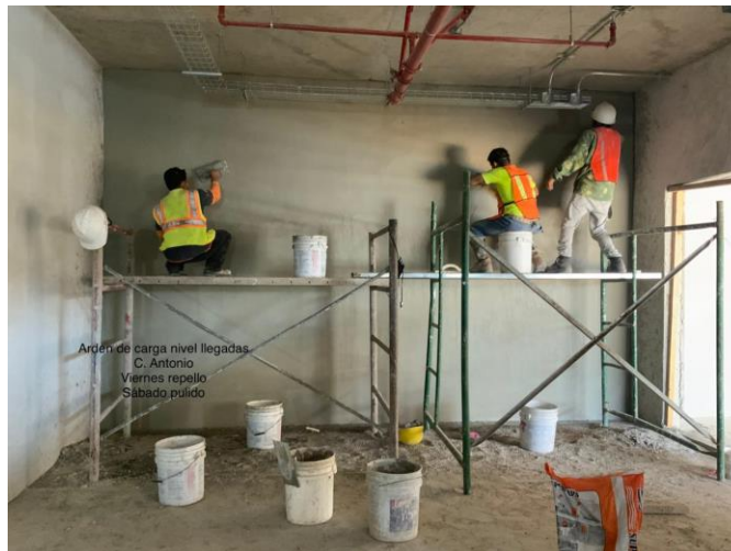
Ilustración 20- Anden de carga
