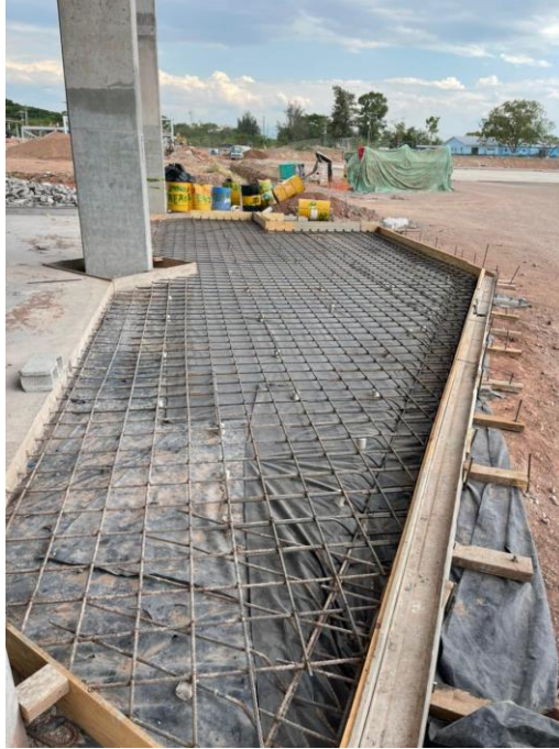
Ilustración 13- Fundiciones de acera
