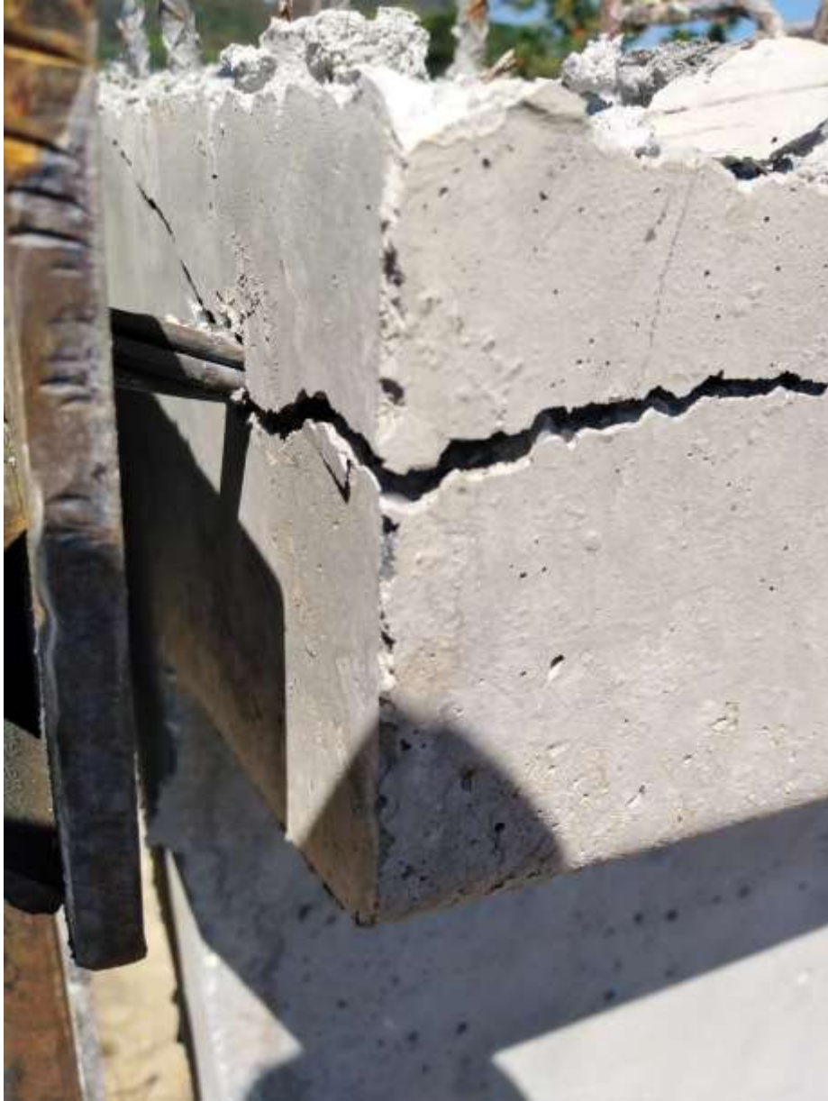
Anexo 5- Fractura en Viga después del destensado
