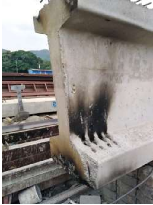
Anexo 6- Estado de Viga antes del maquillado
