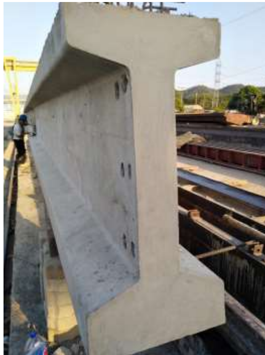
Anexo 7- Estado de Viga después del maquillado
