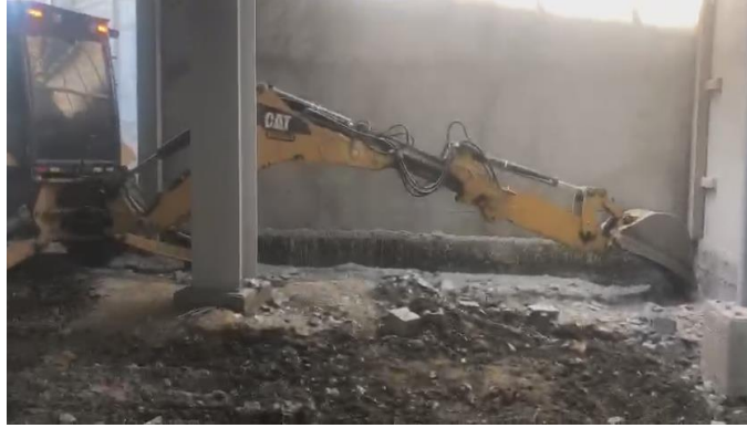
Ilustración 41. Limpieza de material contaminado dentro de la nave
