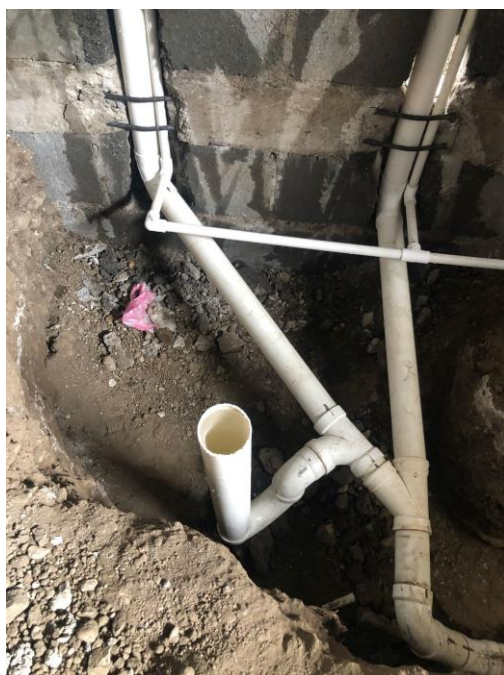
Ilustración 26. Araña de tubería hidrosanitaria
