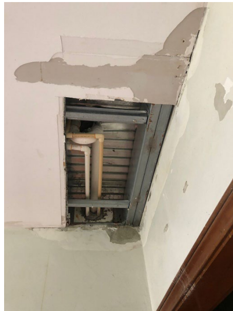
Ilustración 8. Daño en Apartamentos Res. El Barrial
