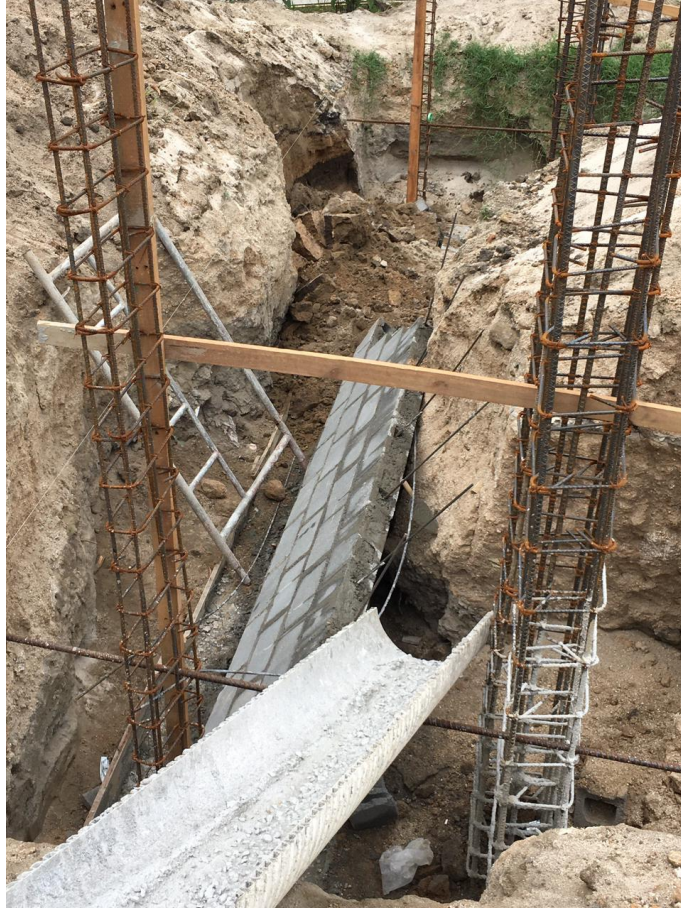
Ilustración 19- Colapso de Zapata corrida sobre eje 52
