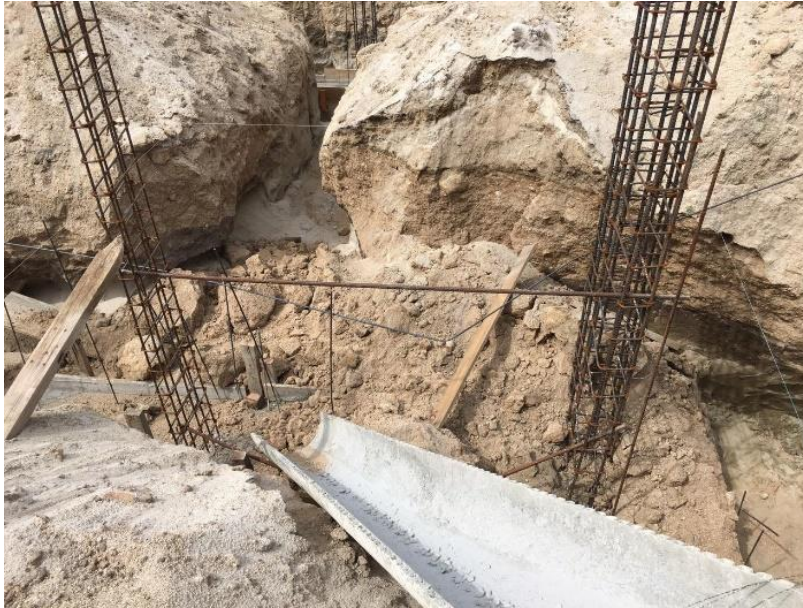
Ilustración 12-Obstrucción de obra por deslizamiento
