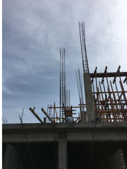
Ilustración 41-Discontinuidad en el plano de los elementos verticales resistentes a las fuerzas lateral
