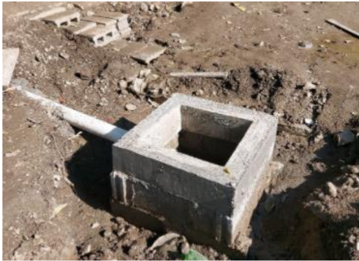
Ilustración 12 - Cajas de registro
