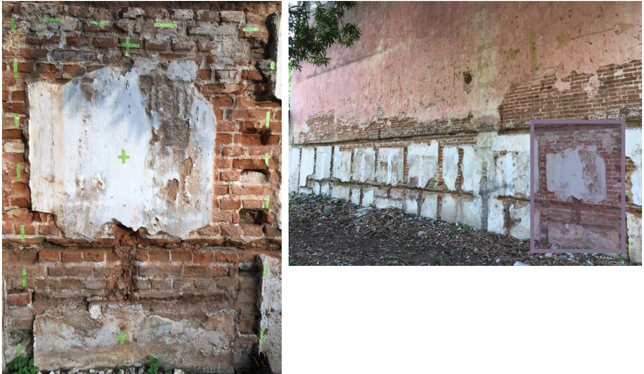
Ilustración 12- Deterioro en pared externa auditorio JTR ala oeste (2.00 x 1.40 m)
