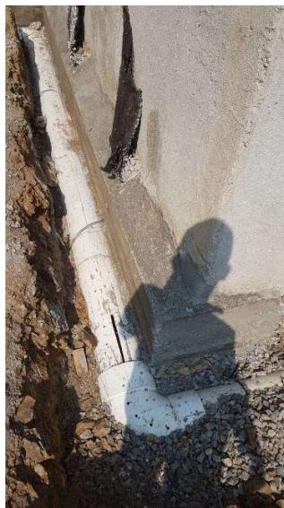
Figura 4. Drenaje en el Pie del Muro A
