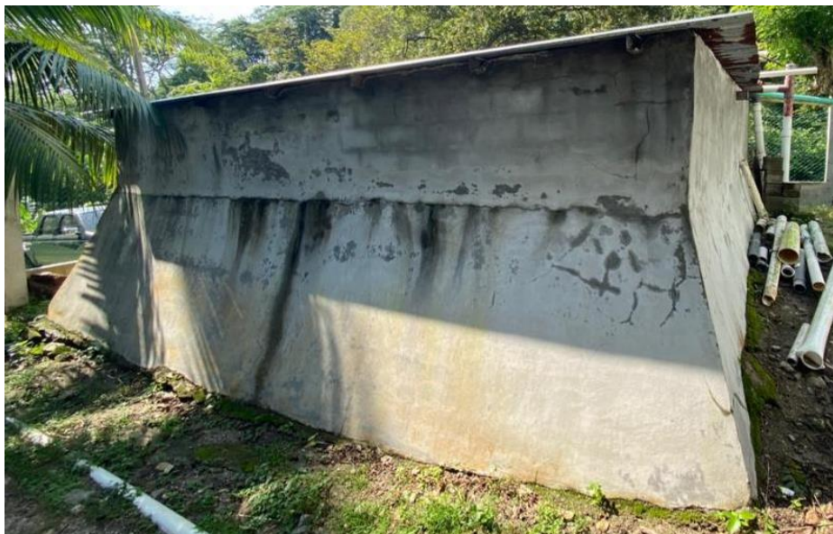
Ilustración 2 Tanque de 45,000 galones
