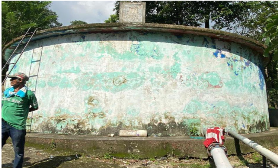
Ilustración 1 Tanque de 84,000 galones
