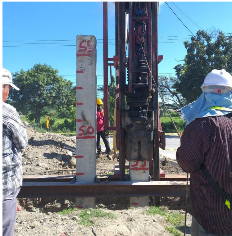
Anexo 6 Hincado de pilotes puente a desnivel 27 calle con bulevar del este
