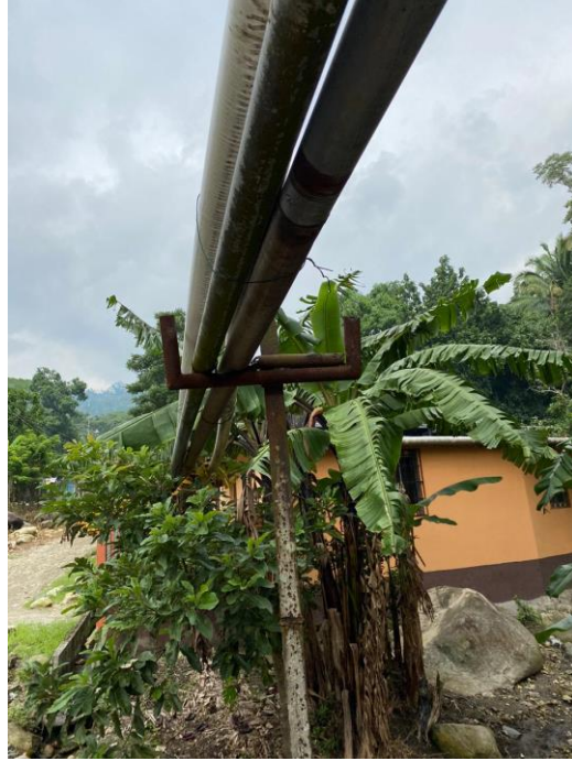
Ilustración 29. Paso aéreo de tubería del pozo al tanque
