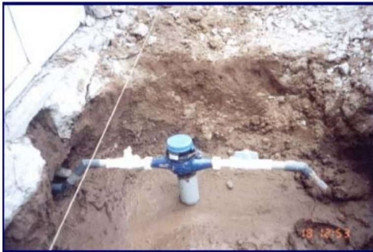
Ilustración 13-Medidor instalado en la Acera
