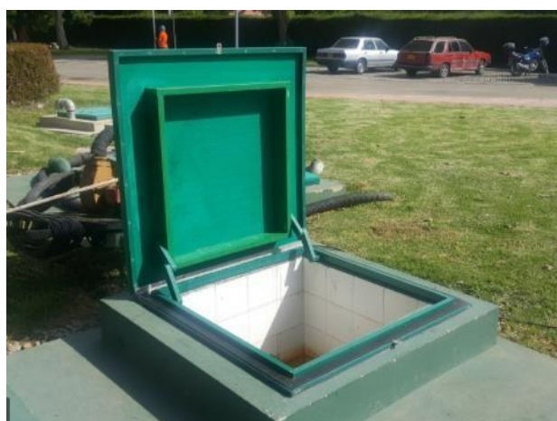
Ilustración 29-Compuerta de acceso a tanque
