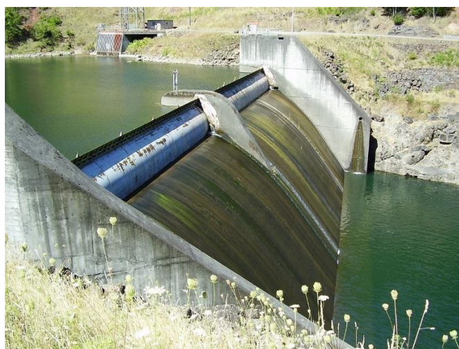
Ilustración 19-Vertedero en captación de agua
