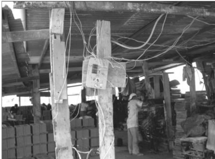
Ilustración 6 - Cableado eléctrico en fábrica Véliz
