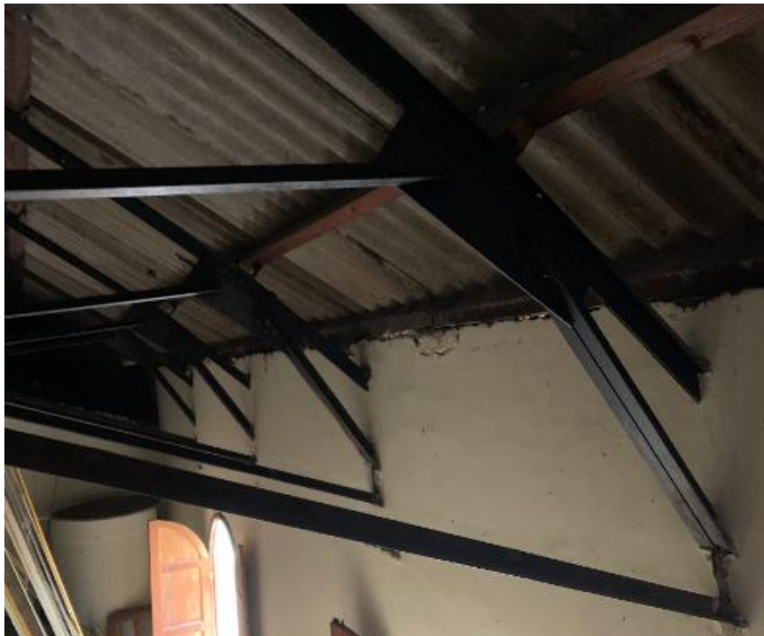
Ilustración 118-Empotramiento de armadura a pared Teatro Nacional Manuel Bonilla
