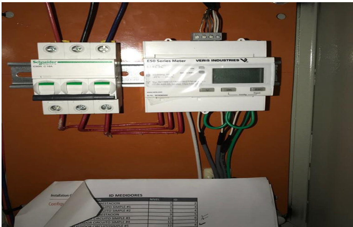
Ilustración 14 Medidores de energía
