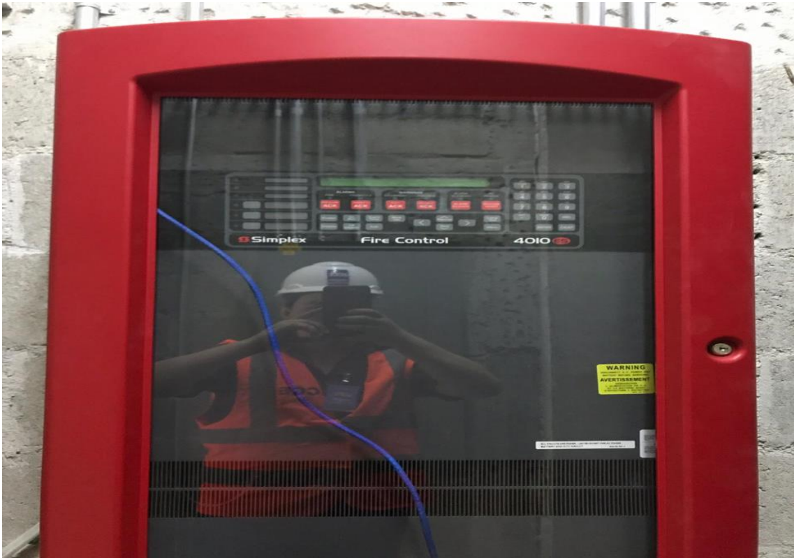
Ilustración 21 Panel de incendio
