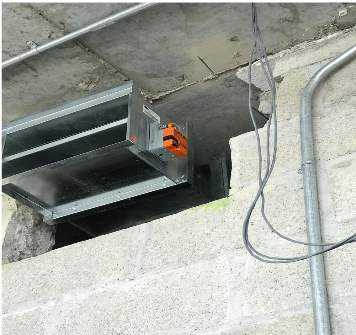
Ilustración 18 Damper en ducto de ventilación
