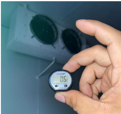
Figura 10. Medición en cuarto frío, termómetro digital Everwell
