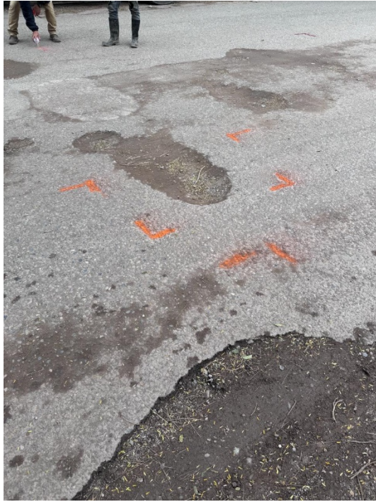
Ilustración 6 Marcaje de baches.
