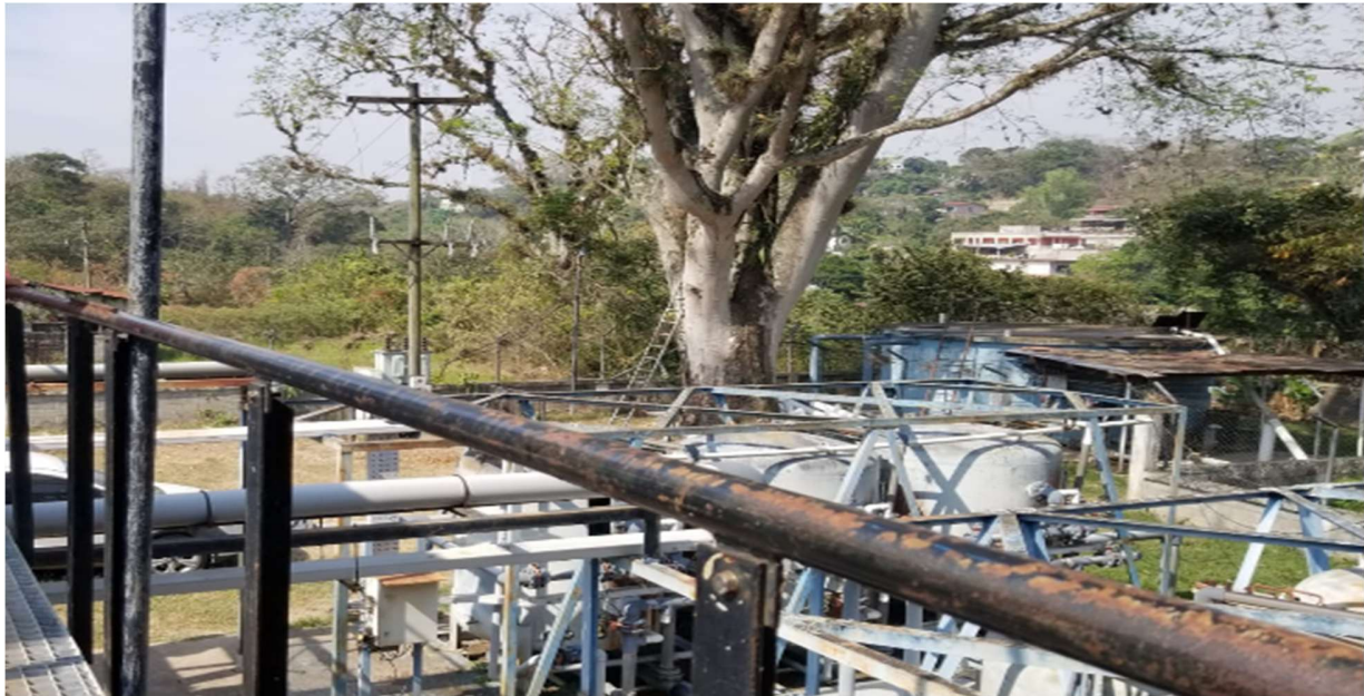
Figura 14: Visita técnica a planta Potabilizadora de Aguas Copanecas
