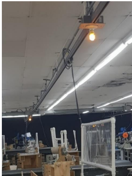
Ilustración 9. Sistema eléctrico por riel
