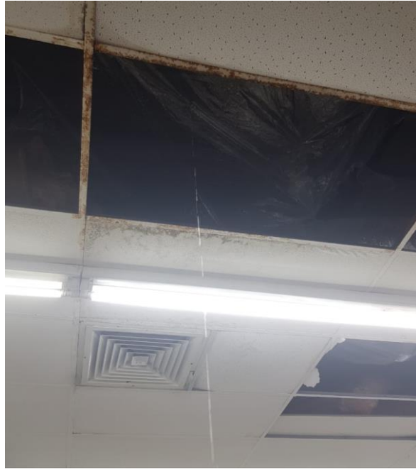
Ilustración 21. Nylon para control de gotera.
