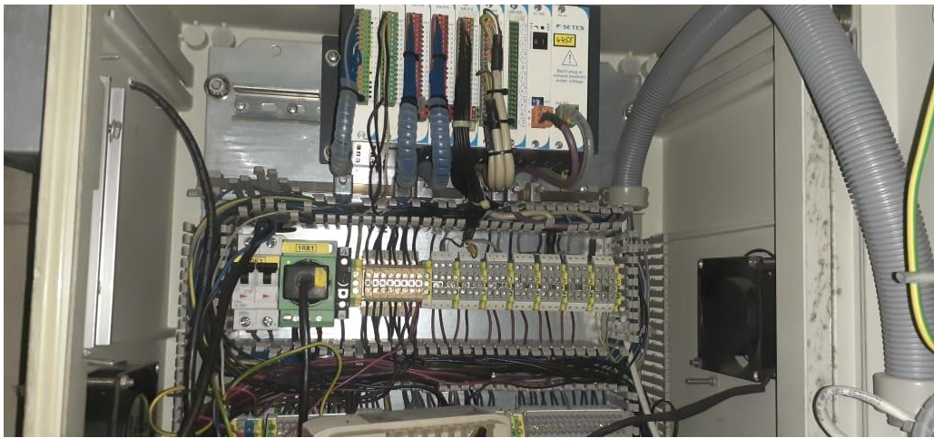
Ilustración 10: Sistema de control de tanques ya existente
