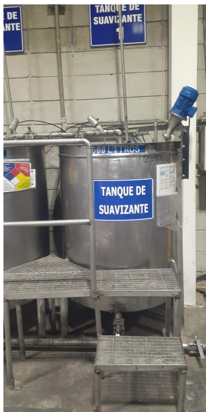
Ilustración 3: Tanques de suavizante
