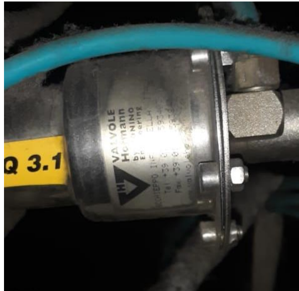
Ilustración 11: Válvulas de plano inclinado y accionamiento neumático
