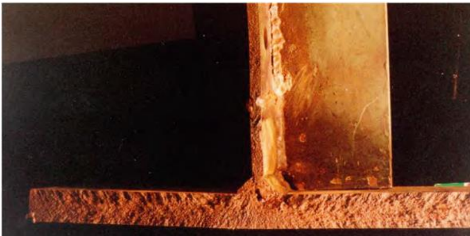
Figura. 14. Fractura en una viga I
