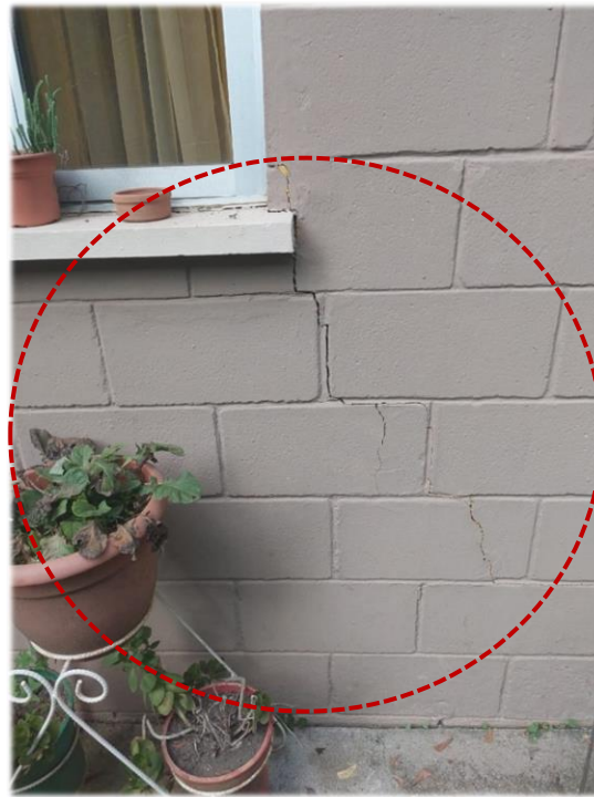
Figura 1. Patología constructiva - Agrietamiento en grada
