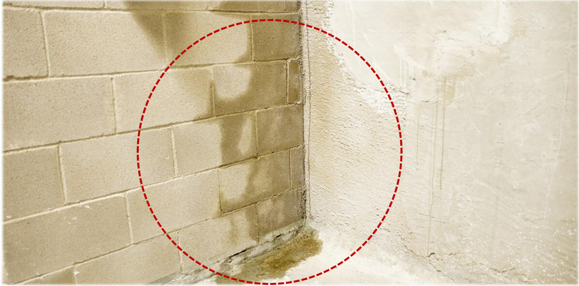
Figura 2. Patología constructiva - Humedad por filtración
