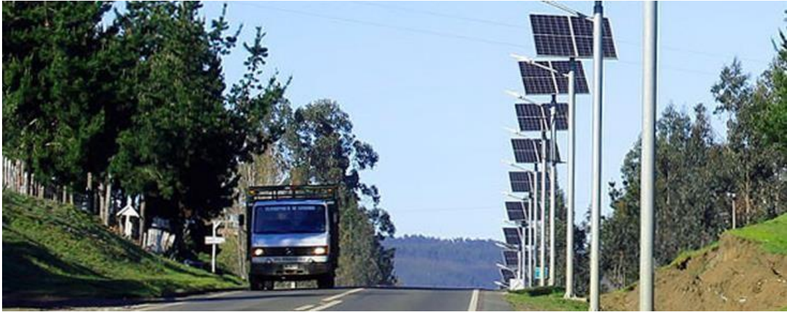
Ilustración 25 - Estructuras sobre postes
