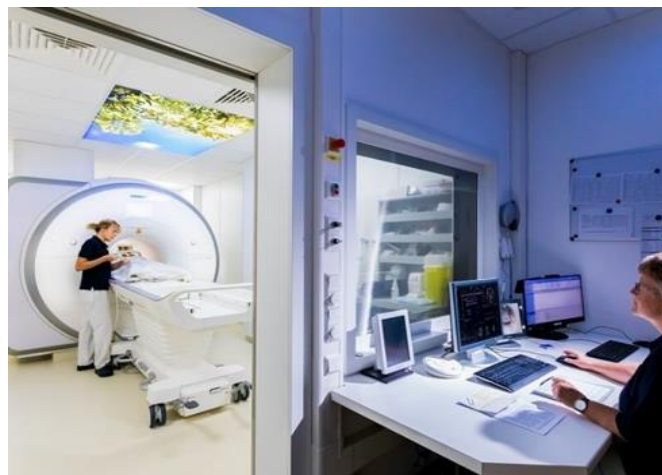
Figura 27 Instalación Interna de la Sala del Laboratorio de Resonancia Magnética.
