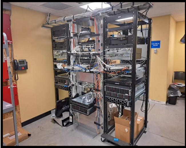
Ilustración 33 instalación de rack en el cuarto de redes
