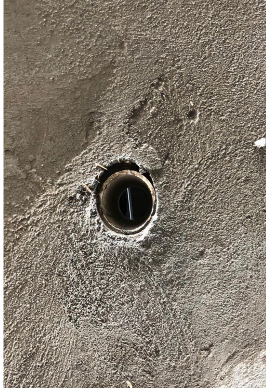
Ilustración 82 Fuga de agua en nivel 5
