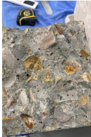
Ilustración 22 - Rotura de viga con representación de agregado grueso poroso
