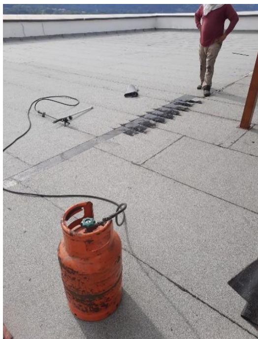
Ilustración 76-Membrana retirada por un mal corte
