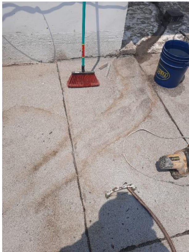
Ilustración 49-Marcas en la membrana debido a empozamiento en el área
