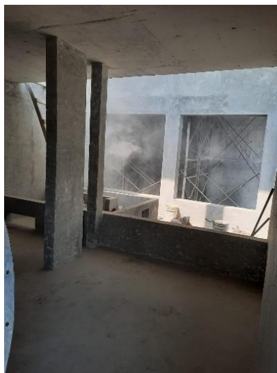
Ilustración 47-Producción de polvo por perforaciones por trabajos externos
