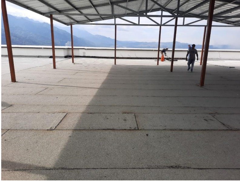
Ilustración 67-Membrana pegada en la parte techada de la azotea
