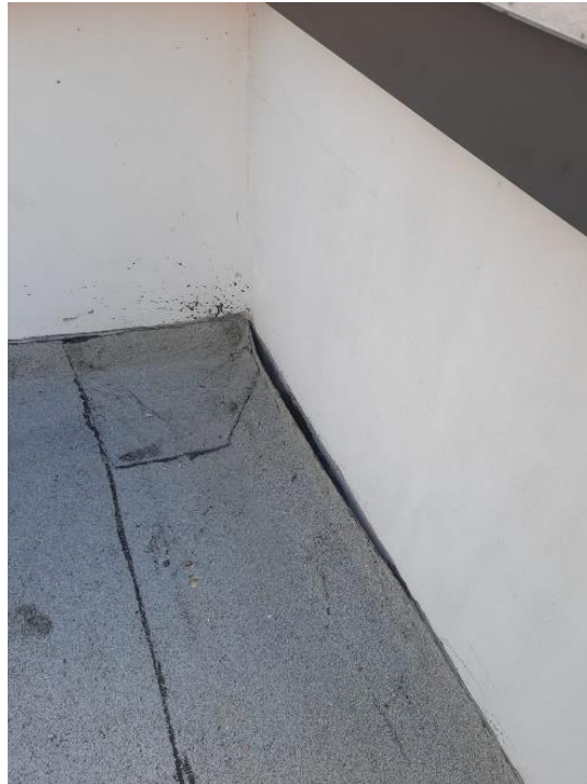
Ilustración 69-Membrana despegada donde se colocará el flashing metalico
