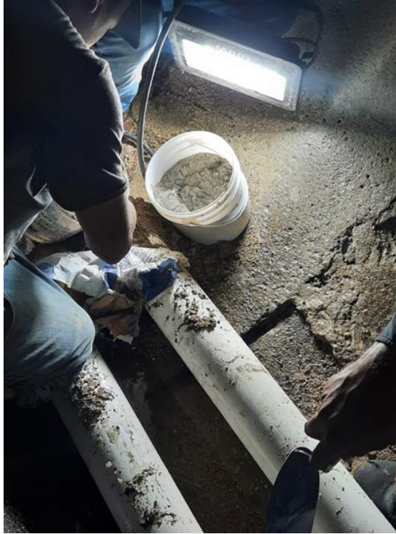
Ilustración 45-Abertura en la parte inferior de la tubería
