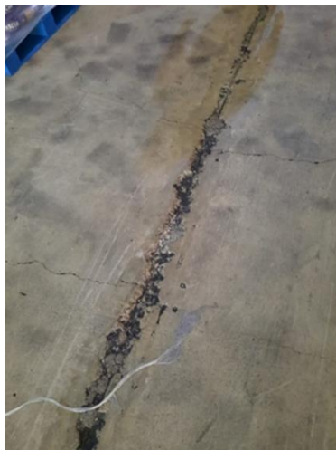
Ilustración 33-Juntas en mal estado de nave industrial
