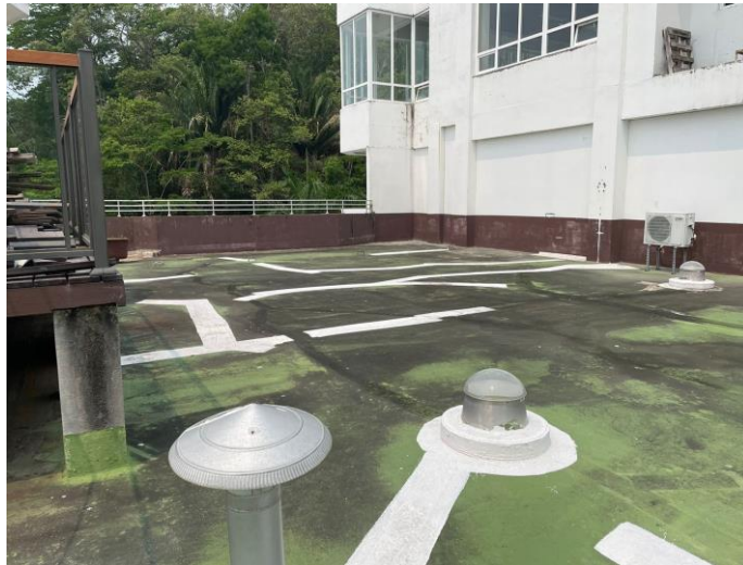
Ilustración 26-Azotea con filtración de agua/ Mont Marand
