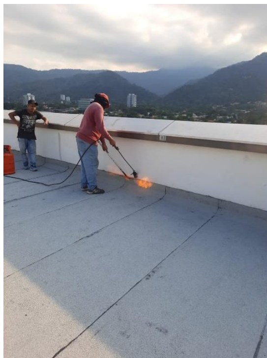
Ilustración 70-Quemado de membrana en todo el perímetro del flashing
