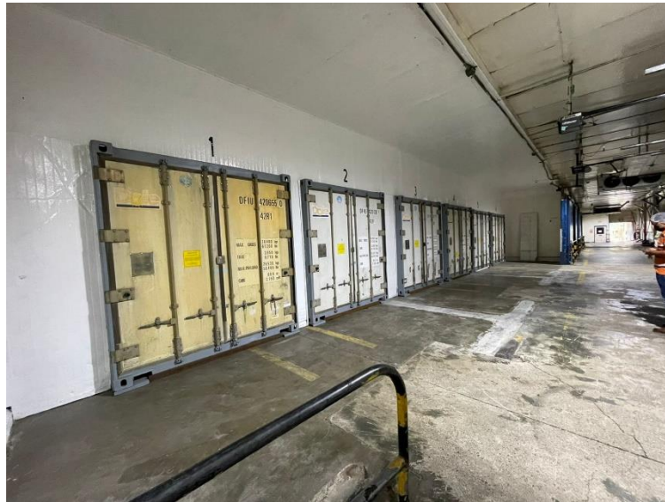
Ilustración 11. Seis unidades de contenedores refrigerados instalados
