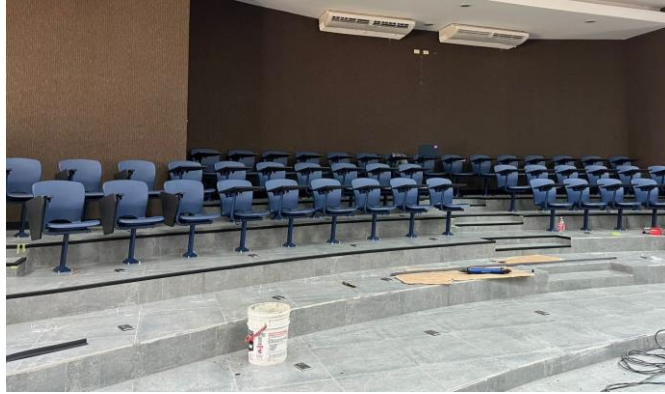
Ilustración 62. Instalaciones de las primeras tres filas de sillas auditorio A2
