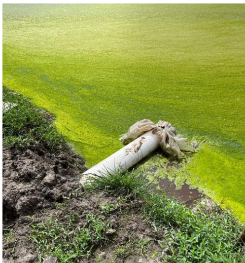
Ilustración 39. Conexión entre laguna y sedimentador
