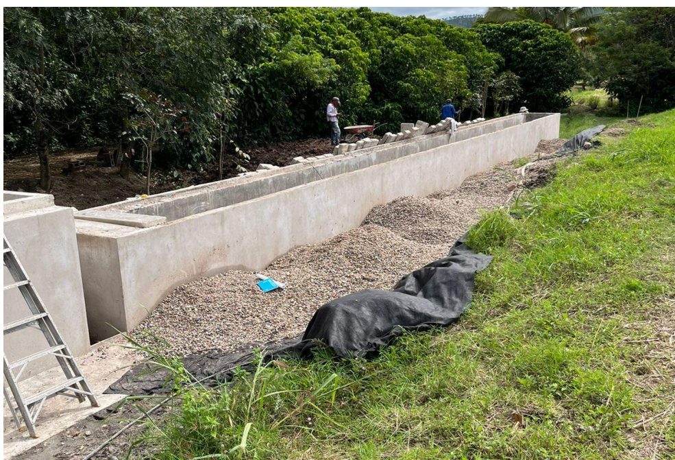
Ilustración 51. Biorreactor- Sedimentador y sistema FAFA
