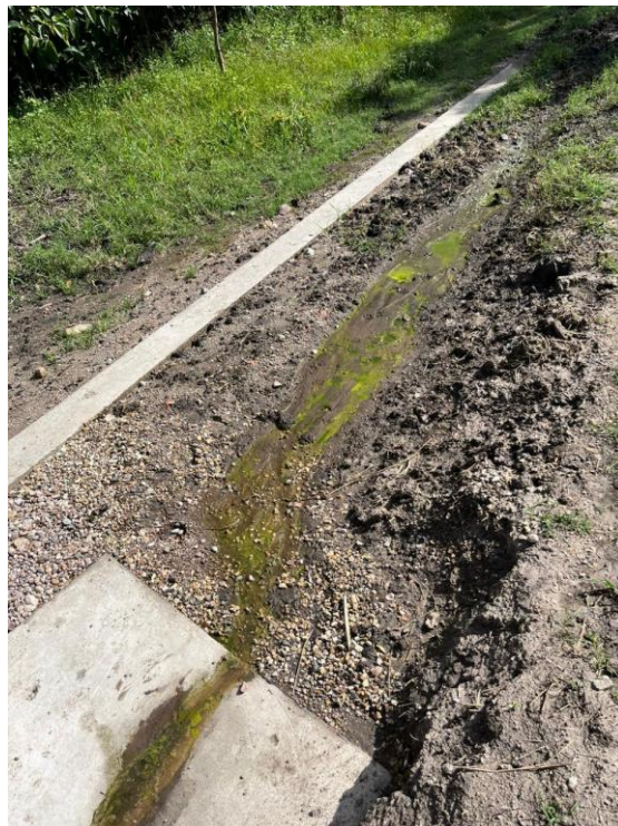
Ilustración 87. Agua estancada por fuga de líquidos en sistema FAFA
