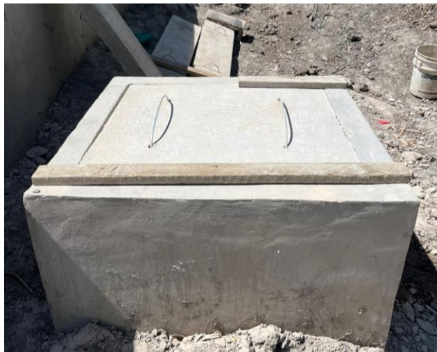
Ilustración 67. tapadera de caja de registro
