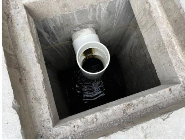
Ilustración 40. Entrada de laguna tubo 8" diámetro
