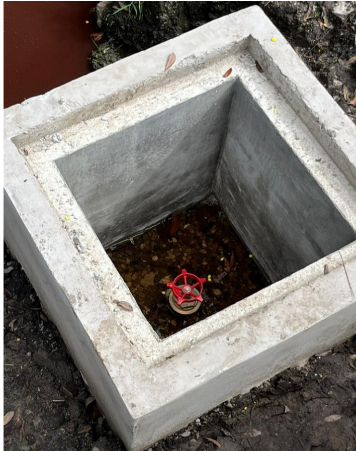
Ilustración 44. Caja de registro + Válvula de bronce
