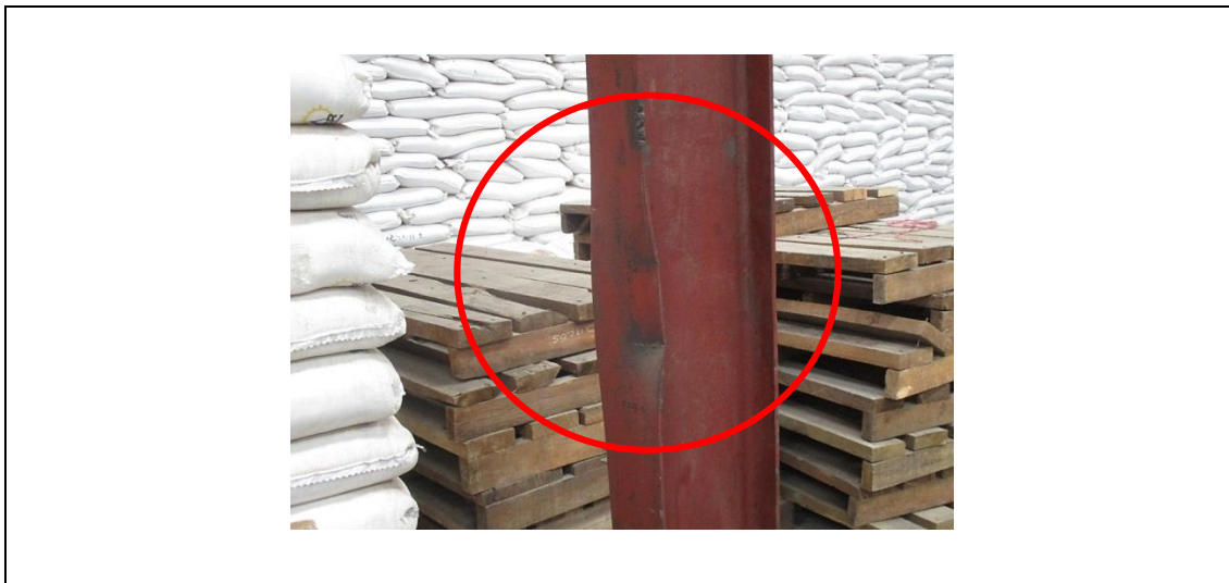
Ilustración 1. Estructura dañada por impacto
