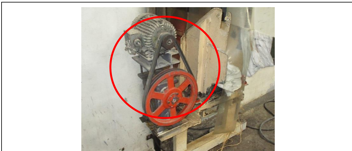
Ilustración 10. Bandas y rodamientos expuestos
