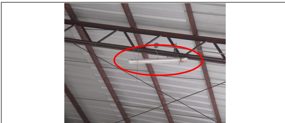
Ilustración 11. Lámparas en mal estado.
