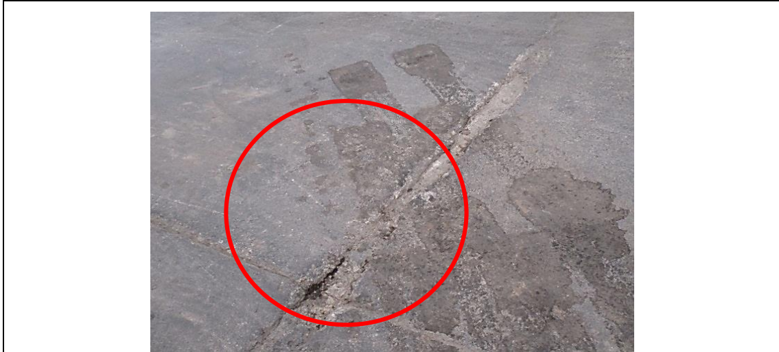
Ilustración 6. Piso en mal estado propenso a ocasionar caídas a un mismo nivel.
