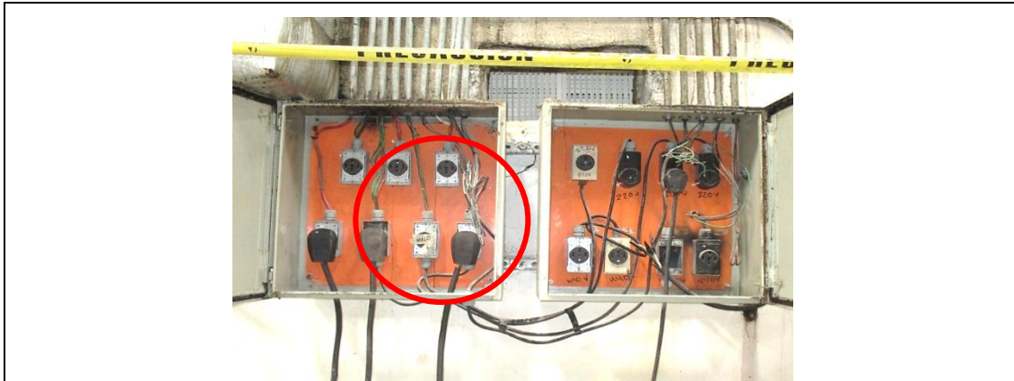
Ilustración 9. Conexiones eléctricas inseguras
