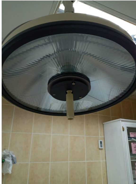
Ilustración 49. Lámpara Quirúrgica Con Bombillo Dañado
