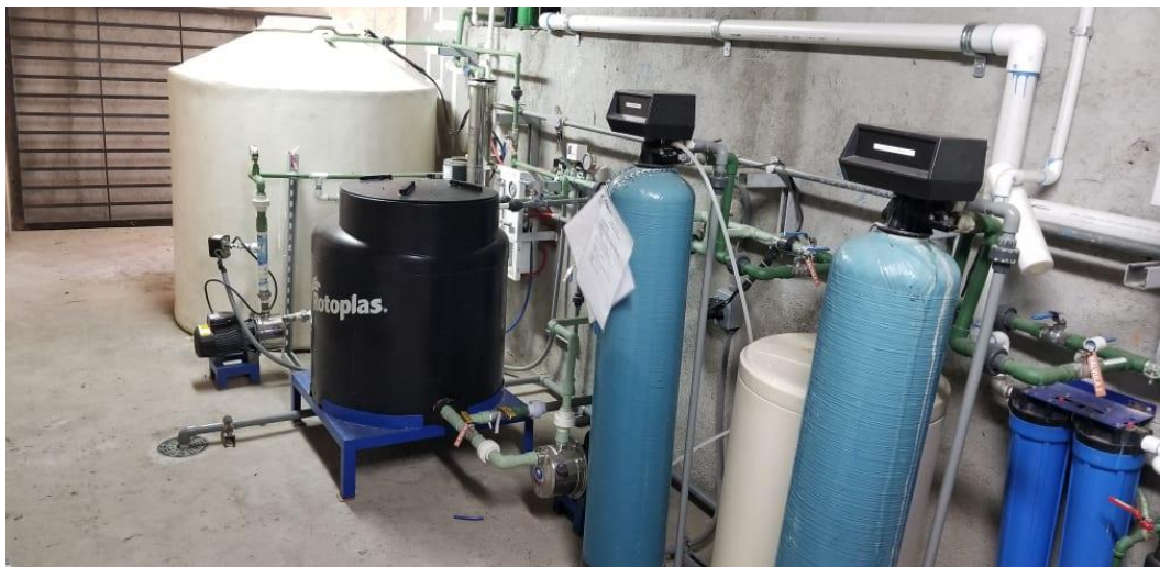
Ilustración 21. Planta de Osmosis Inversa
