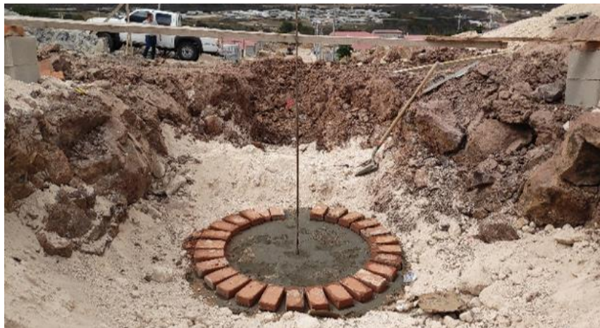
Ilustración 27- Construcción del pozo de inspección para el sistema de aguas negras, 03 de febrero.
