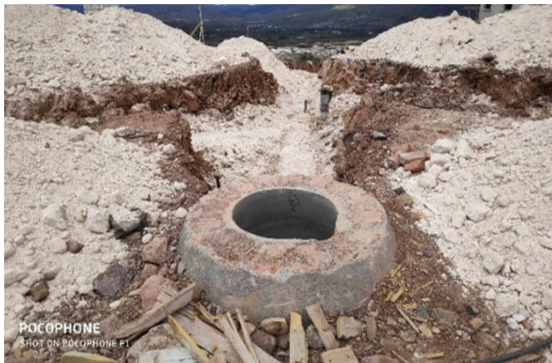
Ilustración 24-Conformación de la base para el sistema de aguas negras, 01 de febrero.
