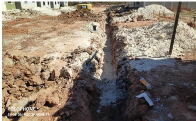
Ilustración 77-Excavación de la segunda brecha del sistema de agua potable, 04 de marzo.
