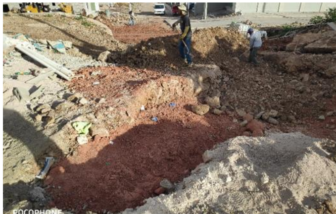
Ilustración 60-Relleno del tramo final del sistema de aguas negras de la calle 08, 20 de febrero.
