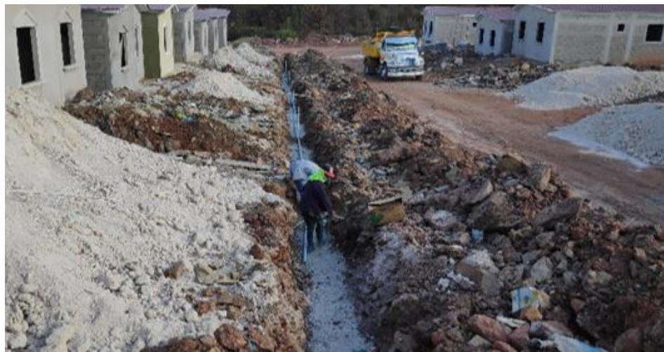
Ilustración 65-Instalación de la tubería del sistema de agua potable de la calle 08, 25 de febrero.
