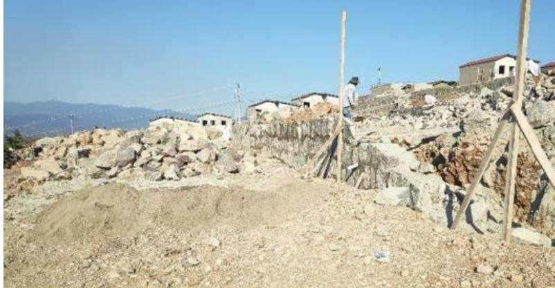
Ilustración 78-Excavación de la segunda brecha del sistema de agua potable, 05 de marzo.
