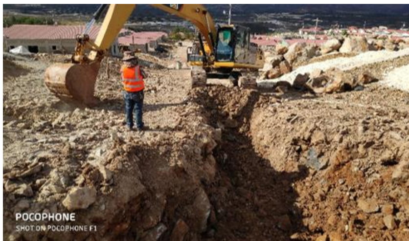
Ilustración 42-Excavación de la tubería principal para el sistema de aguas negras,10 de febrero.
