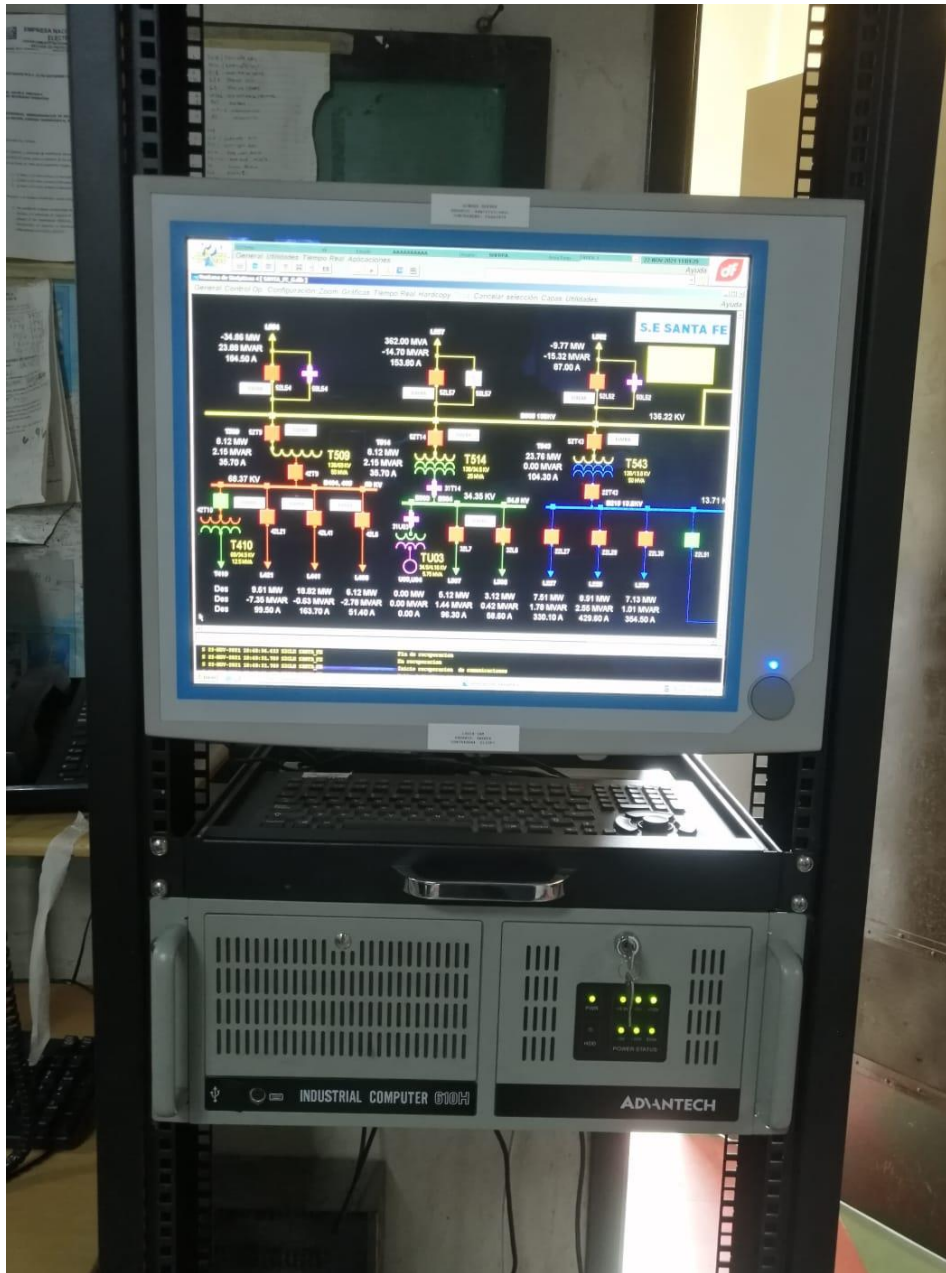
Ilustración 10. 10 HMI instalada en subestación Santa Fe funcional (Autoría Propia,2021)
