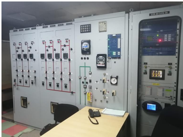
Ilustración 6.1 Tablero de control 2 (Autoría Propia, 2021)
