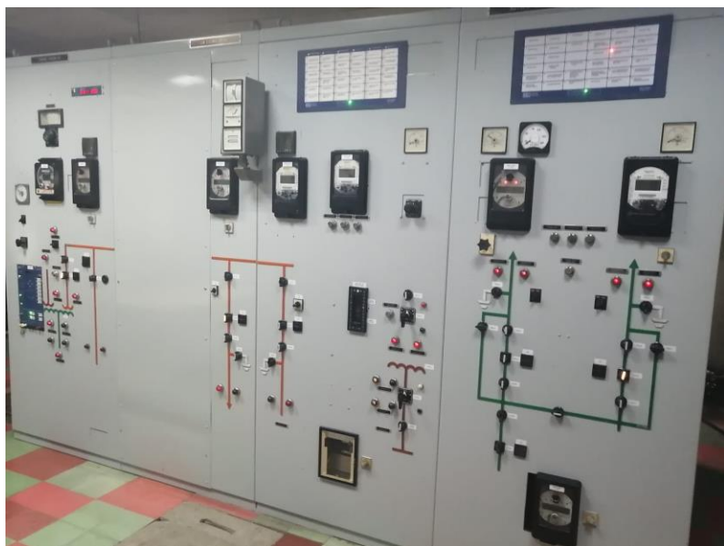
Ilustración 6.1 Tablero de control (Autoría Propia,2021)
