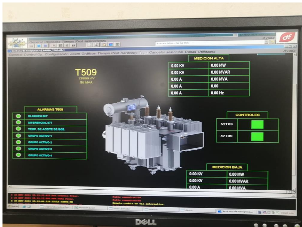
Ilustración 10. 5 Transformador T509 (Autoría Propia,2021)
