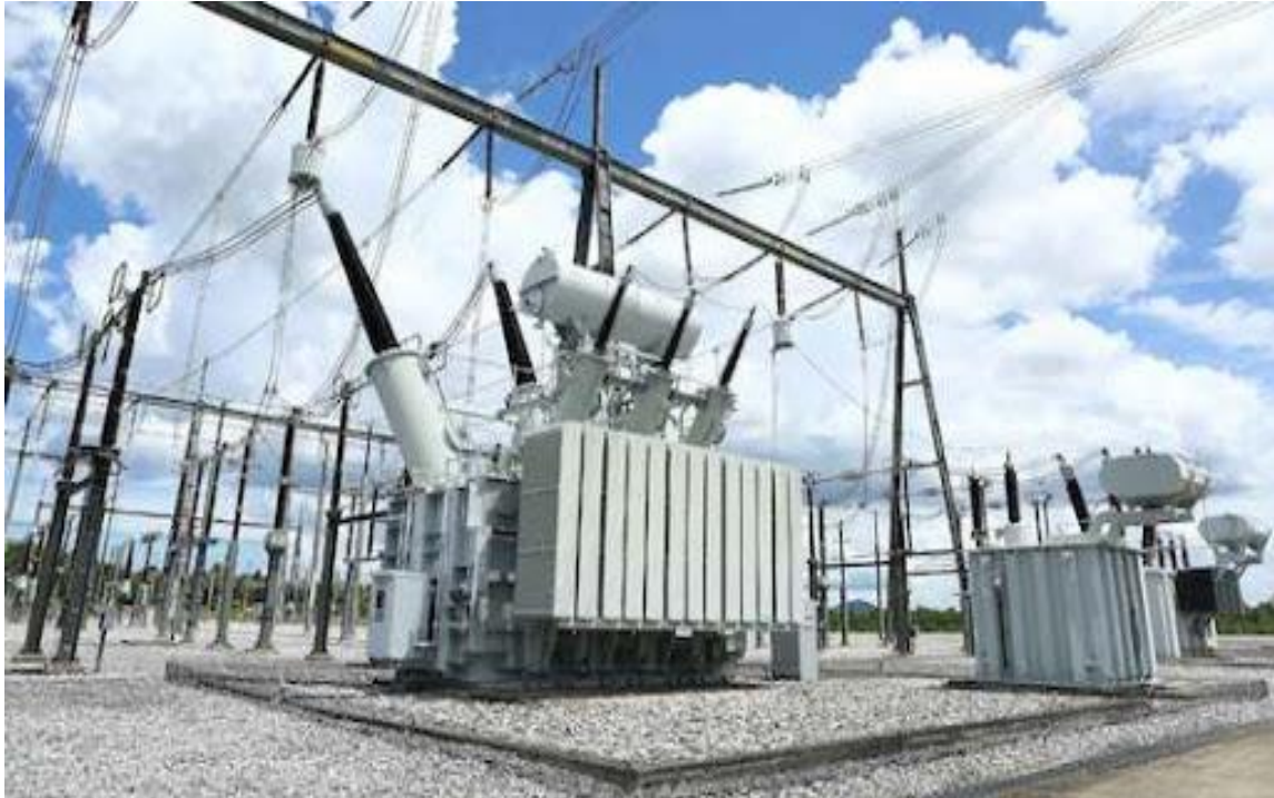
Figura 4.4 Subestación eléctrica reductora
