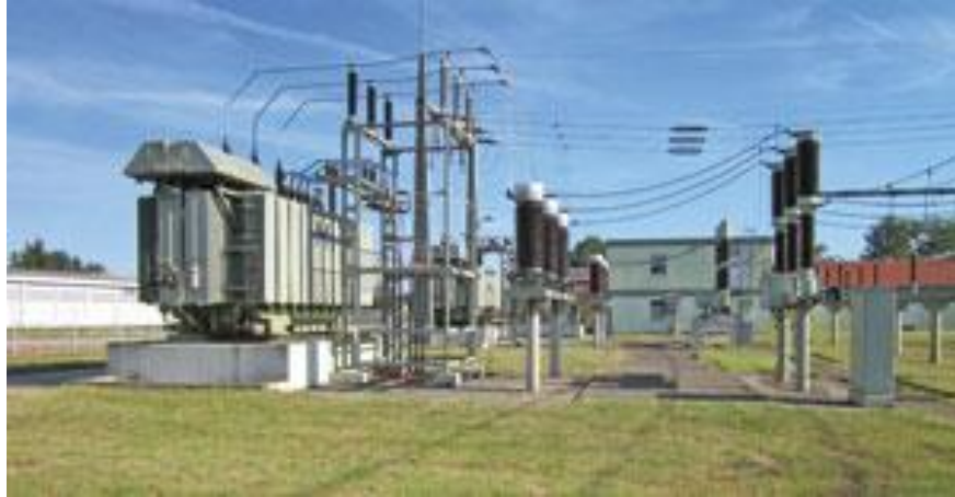
Figura 4.3 Subestación eléctrica elevadora
