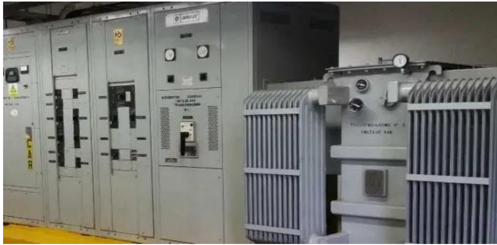
Figura 4.2 Subestación eléctrica industrial
