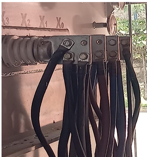
Figura 4.20 Conexión baja tensión transformador de potencia
