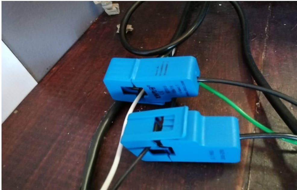
Figura 8.8 Conexión de sensores de corriente. Fuente: (Elaboración propia, 2021)
