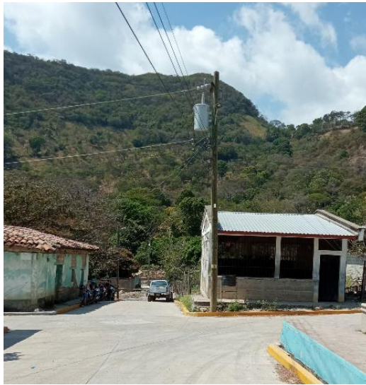
Ilustración 13 Transformador Reductor del Municipio
